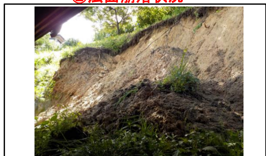
②法面崩落状況
