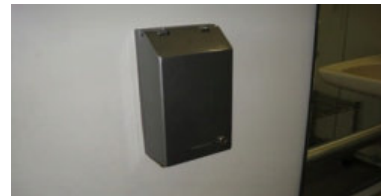
人感センサー式照明の設置
