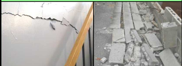
内壁クラック
