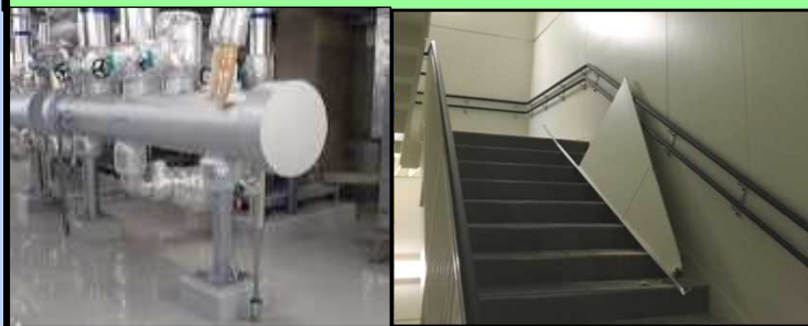
配管の破損による漏水
