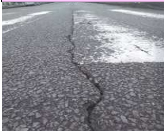
国道3号 あしきた つなぎ まち 韋北郡津奈木町 路面沈下、ひびわれ
