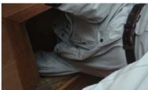
小屋裏点検口より覗き込み、目視・触診可能な範囲の異常の有無を確認。（雨漏れ跡、構造等）
