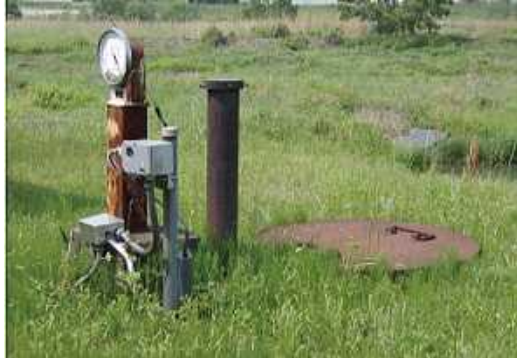
井戸からの取水状況
