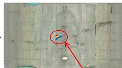
剥落危険箇所
