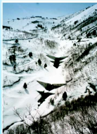
雪崩の発生危険箇所をもつ砂防堰堤(長野県白馬村)
