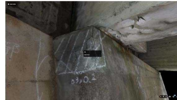
※1 3Dモデル損傷部タグ付け
