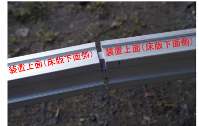
棒部材の接続部分の曲がり
