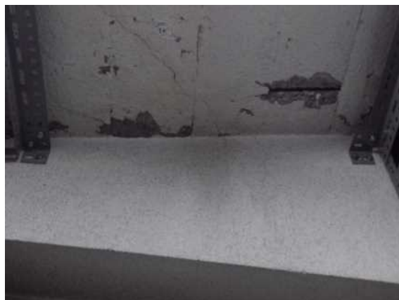
天井：2階床下の鉄筋が腐食し、コンクリートの爆裂が発生
