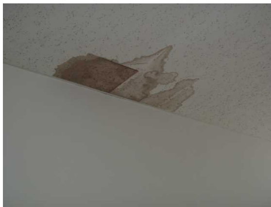
天井：事務室に漏水が発生
