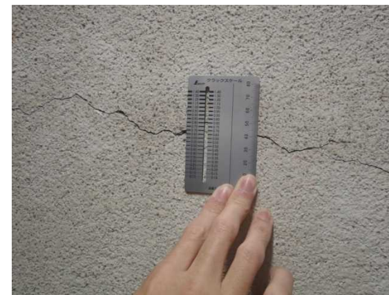
内壁：書庫の壁にひび割れが発生
