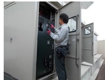
電気設備点検
