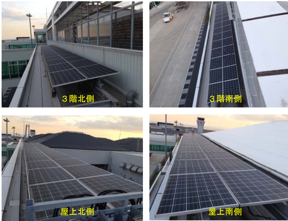
図 4-3 太陽光パネルの設置状況
