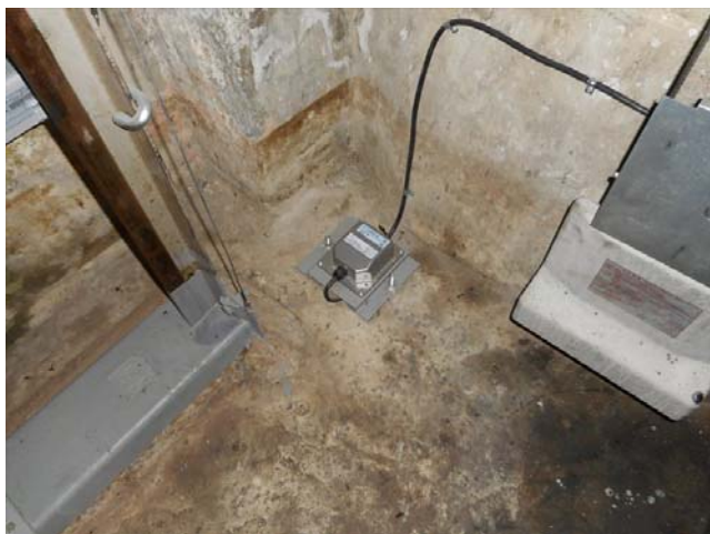
写真：地震時管制運転装置
