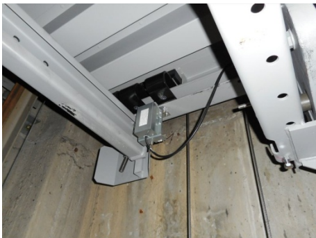
写真：過荷重検知装置
