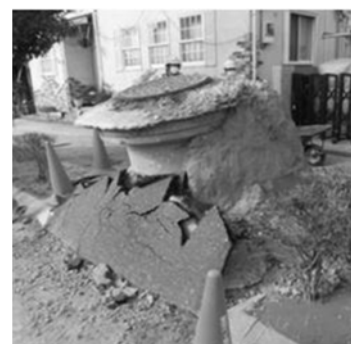
液状化により隆起したマンホール (浦安市)
