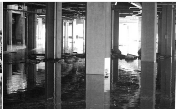
日産スタジアム下部の湛水状況
