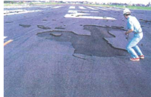
層間剥離が進行して運用時間中に破損した滑走路の状況
