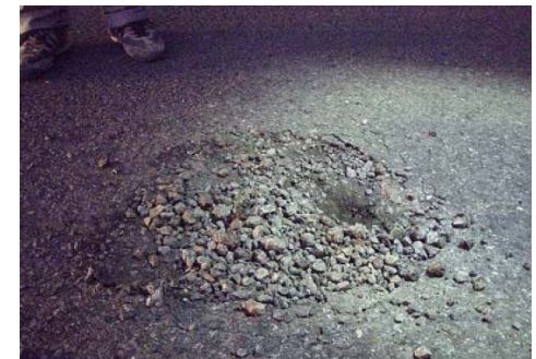
アスファルトと骨材が結合分離した滑走路
