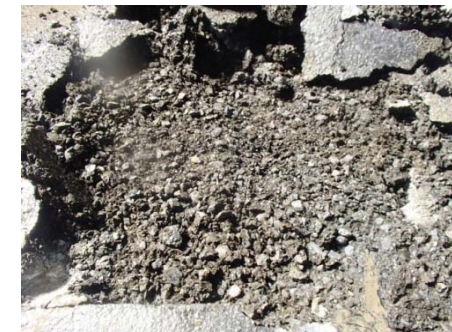
非常に脆く砂利のようになっていた
