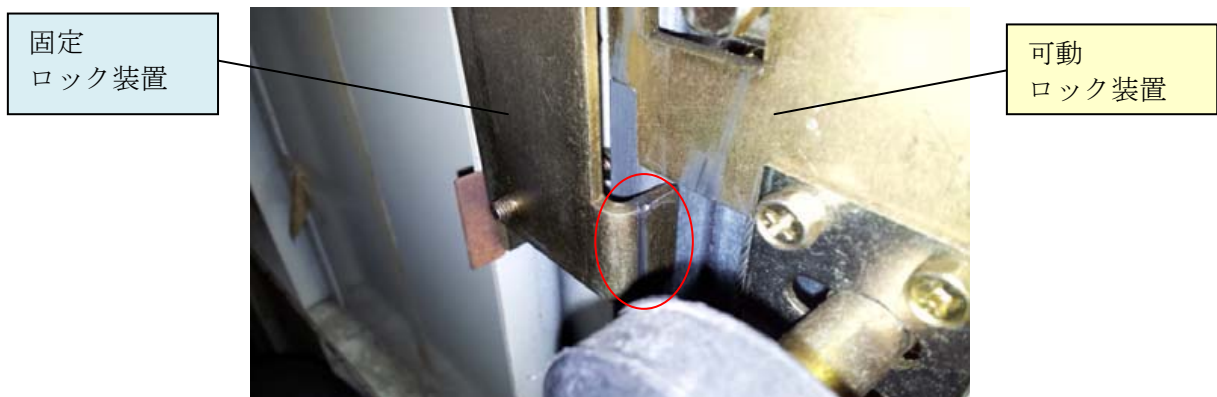
写真Ⅱ-6 1階の固定ロック装置の削れ
