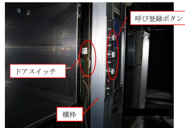
写真2. ドアスイッチの設置位置
