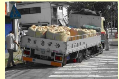
下水管きよに起因した道路陥没
