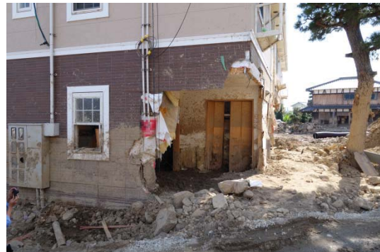
写真 29 付近の木造アパートの被害
