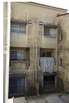
写真4 6号棟山側窓（目立った被害なし）
