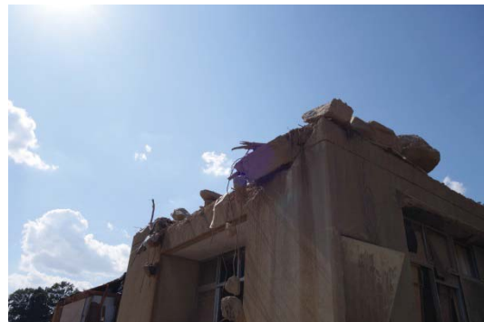
写真 14 パラペットの被害状況
