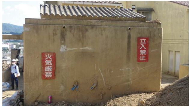
写真 20 プロパン庫の山側外壁
