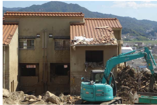
写真6 5号棟西側住戸瓦の損傷
