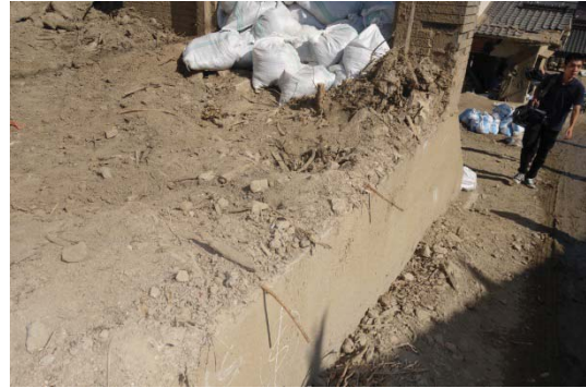
写真 27 流失したとみられる壁の痕跡
