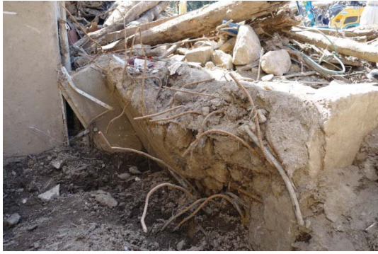
写真 11 5号棟山側 RC 造壁の被害
