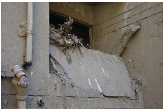
写真9 5号棟山側腰壁の面外変形
