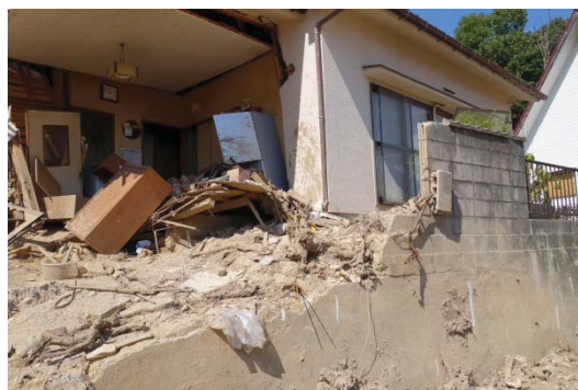
写真 24 ブロック壁の被害
