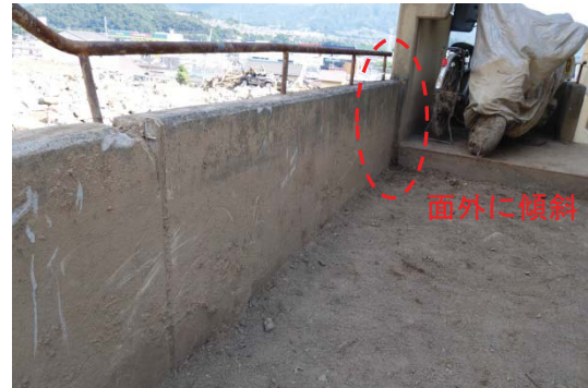
写真 22 8号棟擁壁の面外への傾斜
