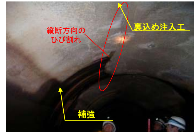
ひび割れが顕著な区間
