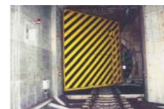
トンネル内防水ゲート
