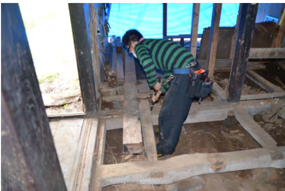
写真 13 シロアリによる根太・土台の食害
