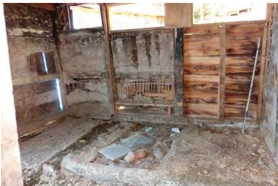
写真 14 土壁は老朽化により全般的に剥離している
