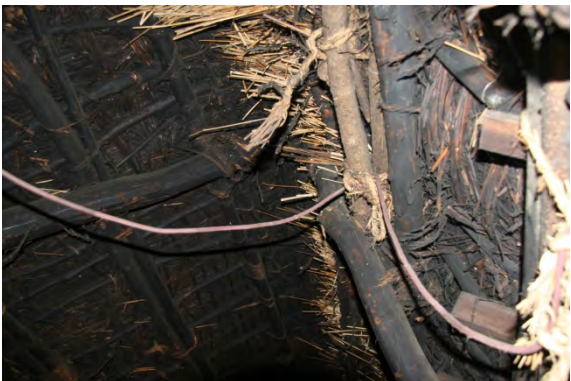
写真 15 さすがが破損している（2箇所）
