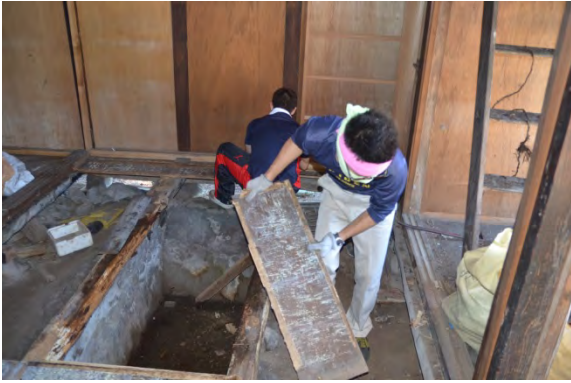
写真 12 湿気により床板が全般的に腐食
