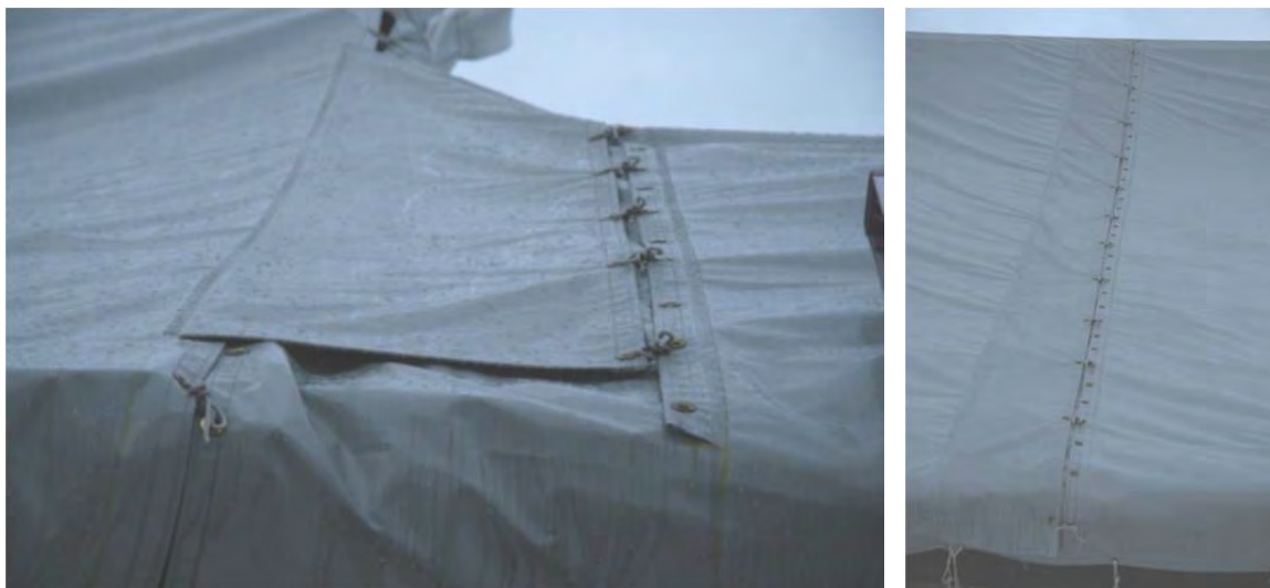
写真 19 落雪シートの接合部
