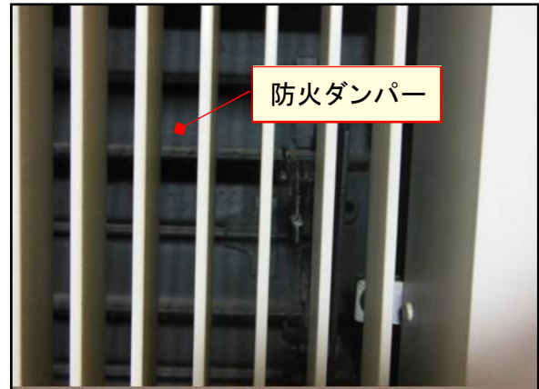
写真3 閉鎖中の防火ダンパー
