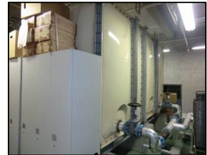
写真6 受水タンク全景
