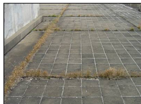
写真2 屋上床目地部の雑草
