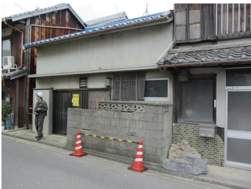
写真 6.9 ブロック塀の一部損傷
