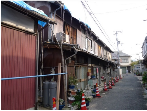
写真 5.23 傾斜した長屋（空き家が数軒）
