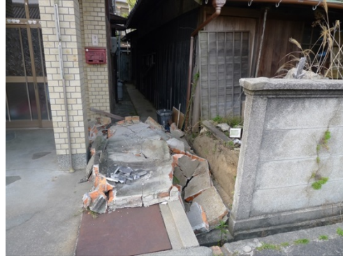
写真 5.24 ブロック塀の被害
