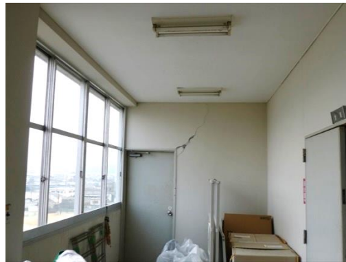
写真 5.28 同庁舎 5 階のひび割れ
