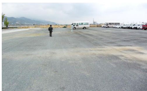
写真 6.2 淡路市役所近隣の駐車場 液状化の噴砂痕
