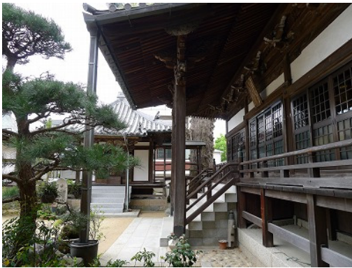
写真 6.18 右に傾斜した柱（本堂）
