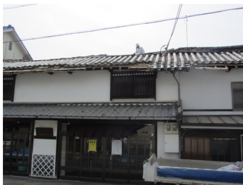
写真 5.2 屋根の被害(「要注意」の黄色紙)
