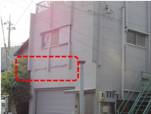
写真 5.25 ALC パネルのひび割れ
