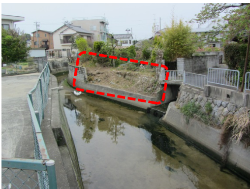
写真 6.15 川沿いの擁壁のくずれ
