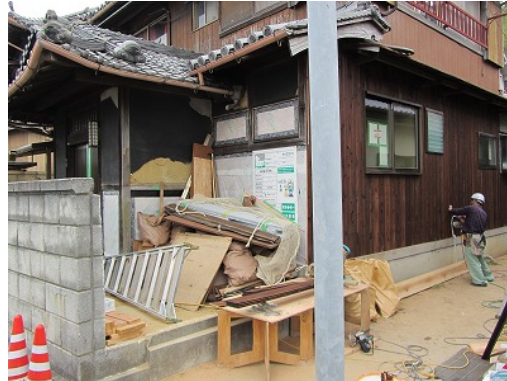
写真 6.25 土塗壁の被害（側面は改修中か）
