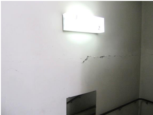
写真 5.27 洲本総合庁舎階段室のひび割れ （打継面）
