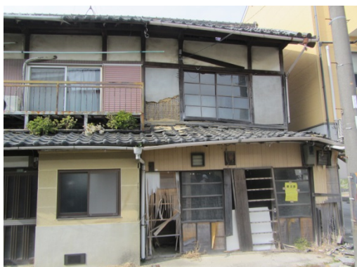
写真 5.12 傾いた木造住宅
