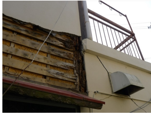
写真 5.17 ラス下地板に生物劣化の痕跡
