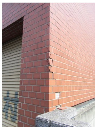
写真 5.5 タイルのひび割れ
