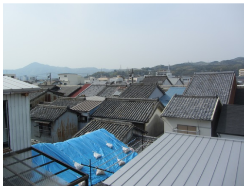
写真 5.4 屋根の被害(ブルーシートで覆う)
