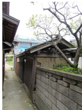
写真 6.29 傾いた木造小屋と屋根の被害
