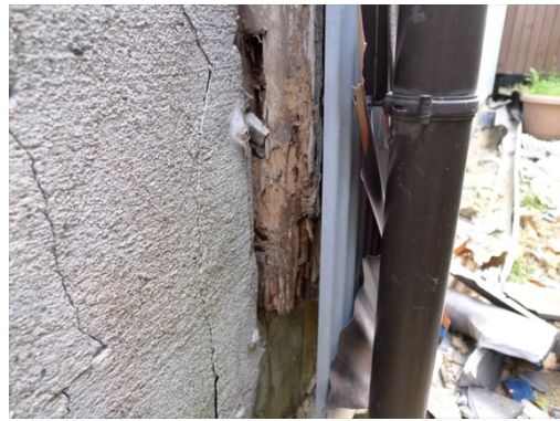
写真 5.8 生物劣化（蟻害）の痕跡
