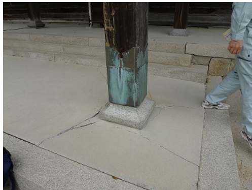
写真 6.33 亀裂の入った向拝下基壇部
