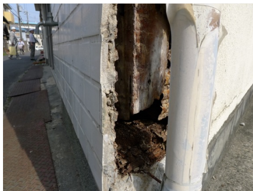
写真 5.11 仕上げ材の剥離 (柱脚に生物劣化の痕跡)
