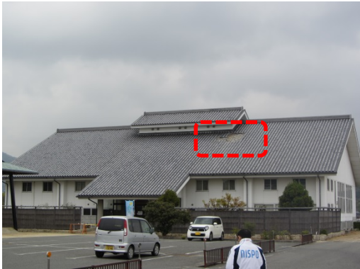
写真 6.5 武道館の一部の屋根瓦の落下
