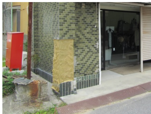
写真 6.10 仕上げタイルの剥落
