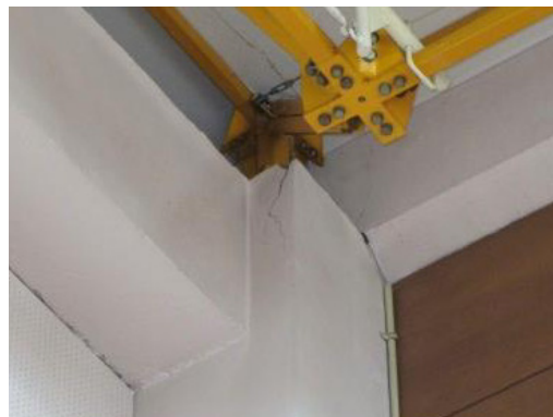
写真 6.8 同 屋根支承部のひび割れ
