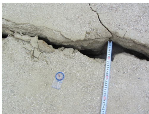
写真 5.15 小学校グラウンド(土)の亀裂
