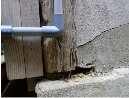
写真 5.7 10cm ほどずれた柱脚
