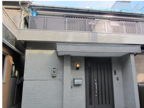
写真 5.26 タイル張り外壁の亀裂
