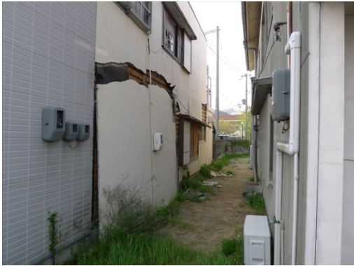
写真 5.16 住宅の剥落したモルタル壁
