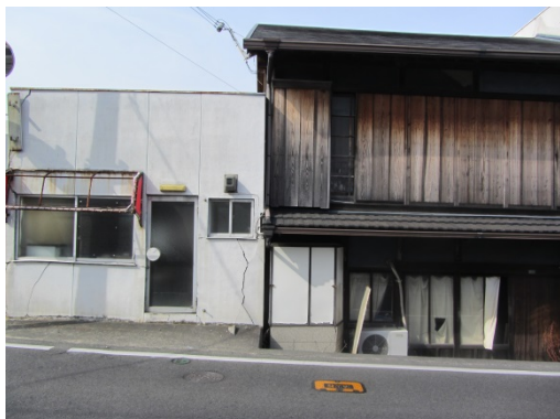
写真 5.10 モルタル仕上げのひび割れ
