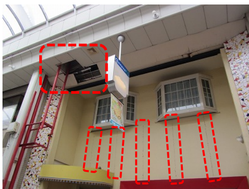
写真 5.1 壁のひび割れ、軒天井の損傷
