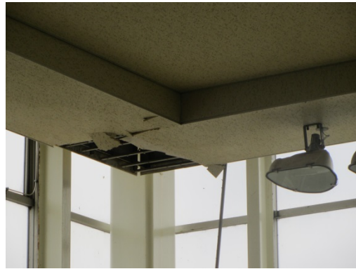
写真 6.4 同プール天井の一部破損
