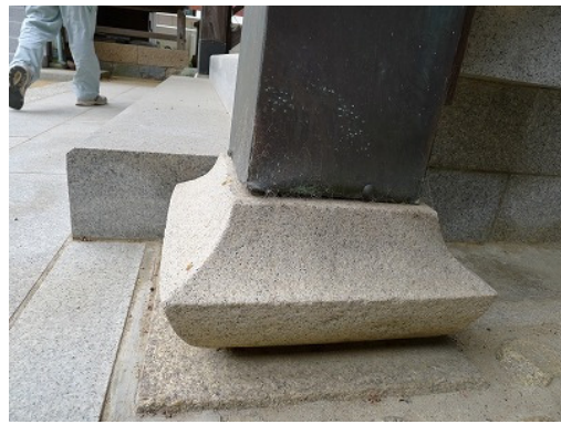
写真 6.19 柱の脚部（写真 6.18 の柱）
