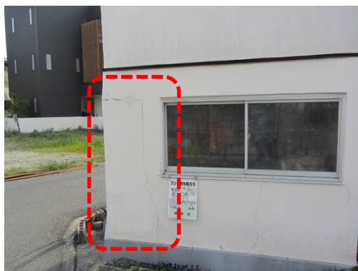
写真 5.13 仕上げのひび割れ
