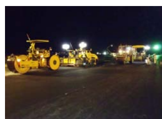
(老朽化した滑走路舗装の改良)
