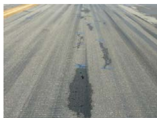
(老朽化した基本施設舗装)
