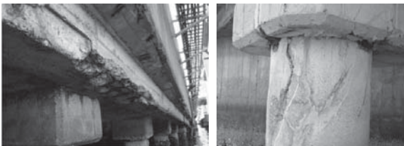
鉄筋コンクリート桁における 主要な鉄筋の腐食 橋脚部における コンクリートのひび割れ
