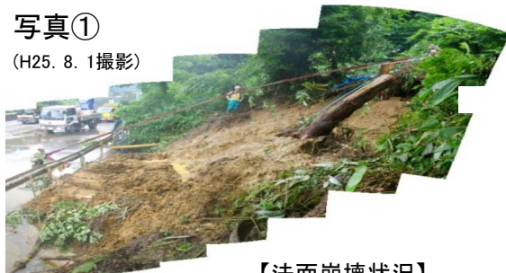
【法面崩壊状況】
