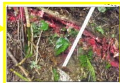
【法面亀裂・段差状況】
