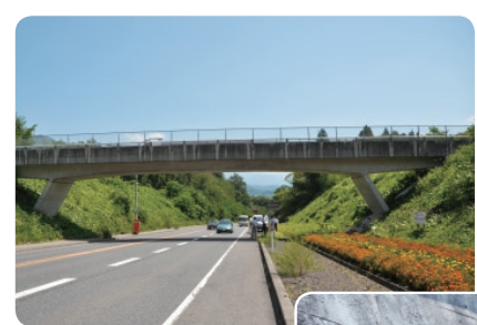
瀨森橋(昭和60年築)にはコンクリートの剥離などが見られる。交通量の多い国道17号に架かるため、補修工事対象に。
