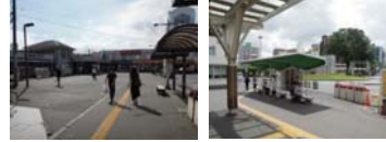
■ シェルターや舗装などの老朽化
