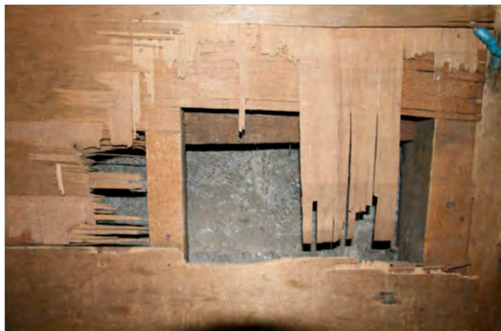
写真26 中央卸売市場倉庫 1階内壁
