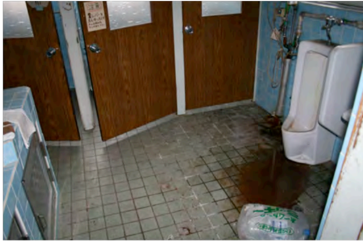
写真51 旧花園病院 1階トイレ
