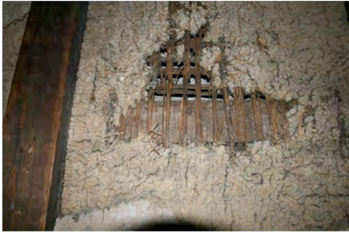
写真47 越後屋家具店石蔵 2階内壁部分 土壁である。歴史性は充分あるが損傷があまりにもひどい。 補修は効かないであろう。特に2階は住宅として使用する提案 であることを考慮すると剥離し内部よりグラスウール充填で断熱を図る。 その後土壁を復元するか、ボードにクロスかの選択肢がある。 土壁を復元するには現状の壁を解体し稲わらを配し、鏝で土を塗る。
