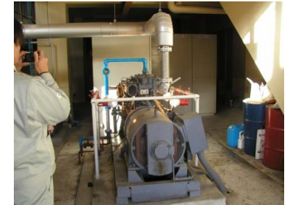
■ 予備発電機設置の事例 水門の電動化・遠隔化に加え、バックアップ動力として予備発電機を設置している (和歌山県 水門)
