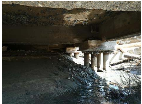
建物基礎が露出
