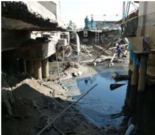
倉舎周囲の地盤流出
