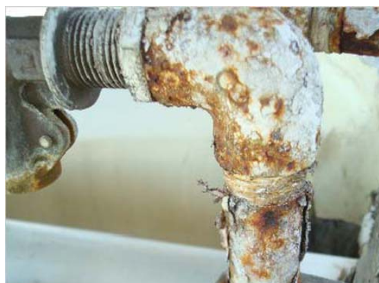
腐食した給水管
