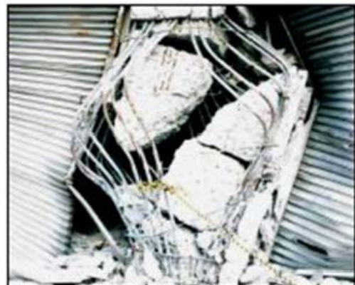
店舗1階柱の圧壊
