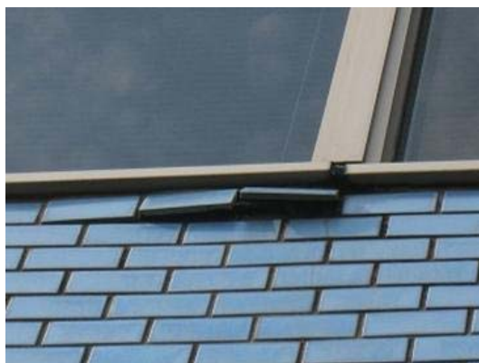
落下のおそれがあるタイル
