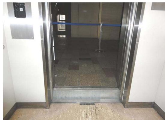
エレベーター着床時の段差
