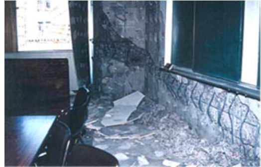
内部の被災状況
