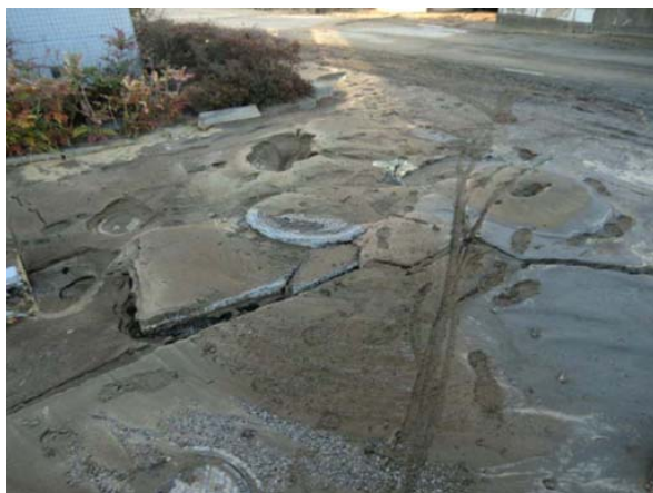
倉舎が液状化被害を受け、 外構の地盤全体が沈下。
