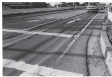
(舗装のわだち掘れ)
