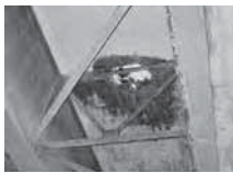
(橋梁の抜け落ち)
