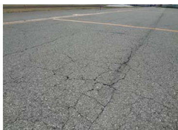
(老朽化した基本施設舗装)
