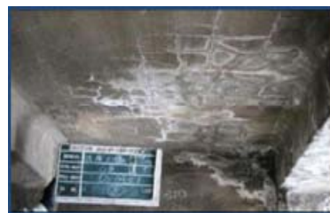
床版ひびわれ
