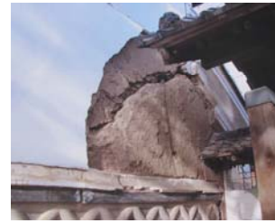
■村田町における土蔵の被害
