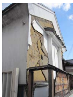
■白河市における土蔵の被害
