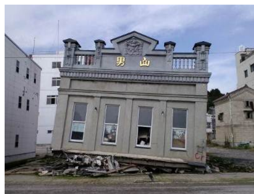
■気仙沼市で破損した歴史的建造物
