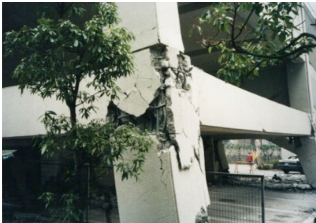
最近の接合部の地震被害
