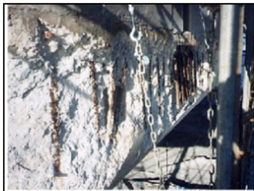
堰本体の鉄筋露出
