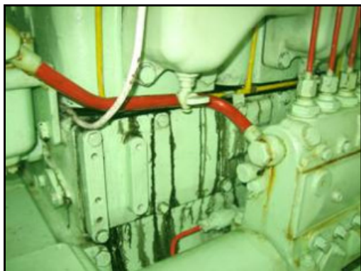
ポンプ原動機からの オイル漏れ
