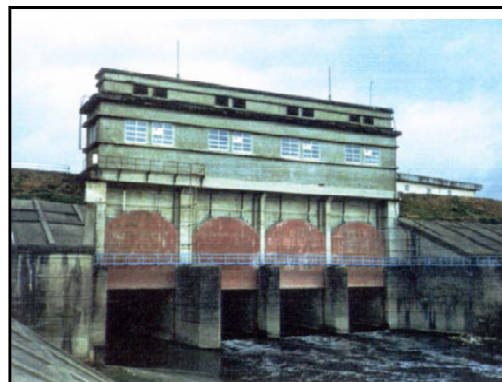
樋門の老朽化
