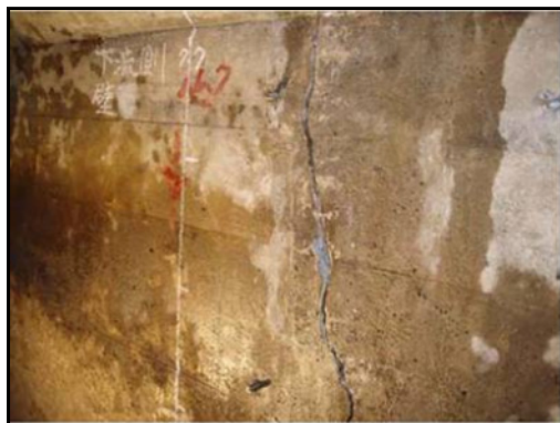
樋門函体のクラック
