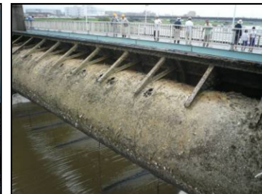
堰ゲートの腐蝕
