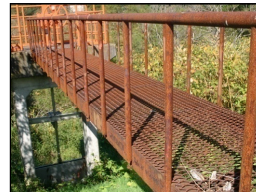
樋門管理橋の腐蝕
