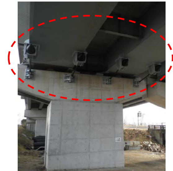
落橋防止装置
