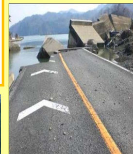
津波で被災した国道45号
