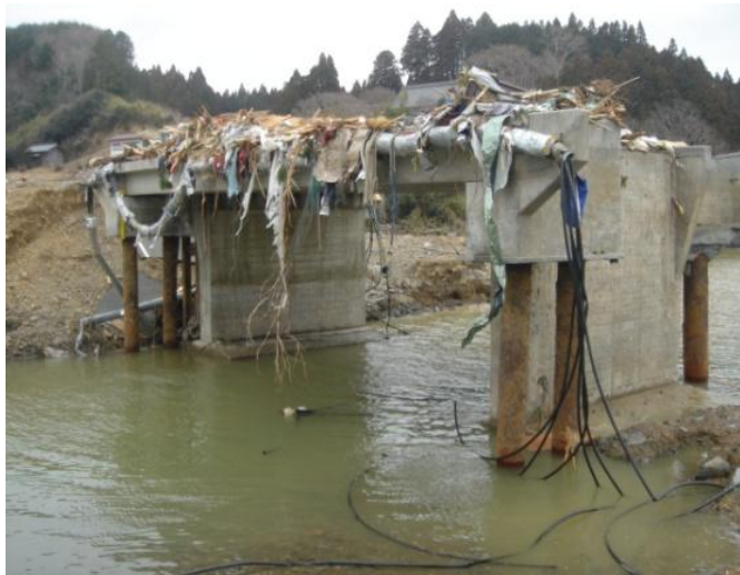
▲被災状況(橋台背面盛土流出)
