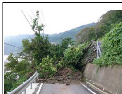
西郷都万郡線道路閉塞状況（隠岐の島町油井地区）
