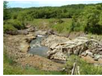
写真 河床低下区間の状況
