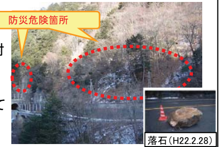
図4 防災危険箇所および落石状況
