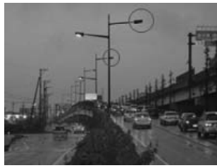
<高架橋照明の減灯>
