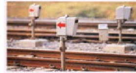
障害物検知装置
