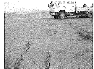
【誘導路の劣化状況】
