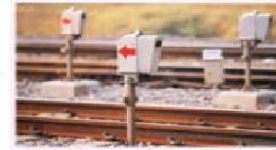
障害物検知装置
