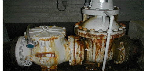
青函トンネル排水ポンプ吐出弁(改修前)
