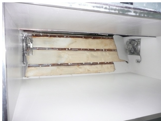
天井が落下したトップライト部分を下から見上げた写真
