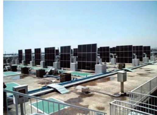
水処理施設の点検時はパネルを垂直に立て作業スペースを確保
