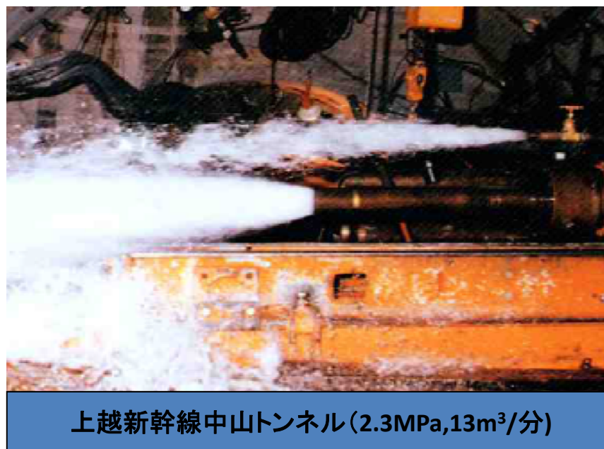
断層破碎帯、亀裂の存在等
