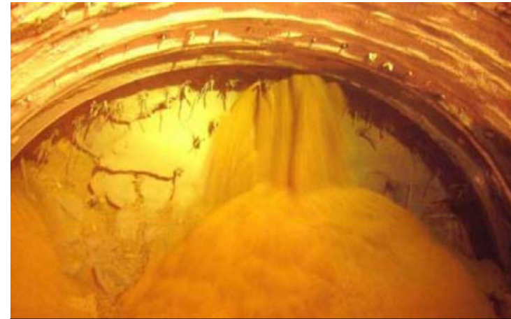
三本木原トンネルの切羽崩壊
